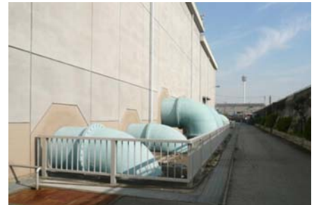
排水場 海への巨大排水管
