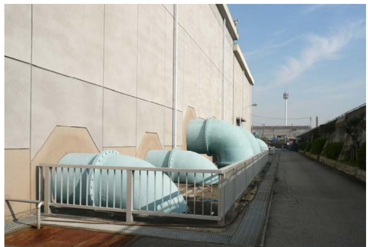
東浜排水場 の巨大排水管 5 基並んでいる
