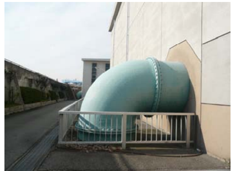
内港・河川の水を海へ排水する巨大配水管
